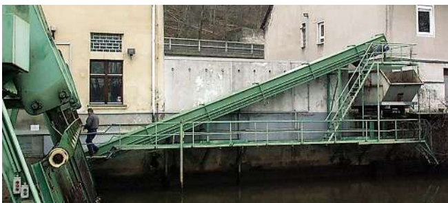
▲ Spezialförderer für Treibgut großer Stückgröße in einem Wasserkraftwerk
